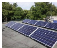
Solaire au sol
